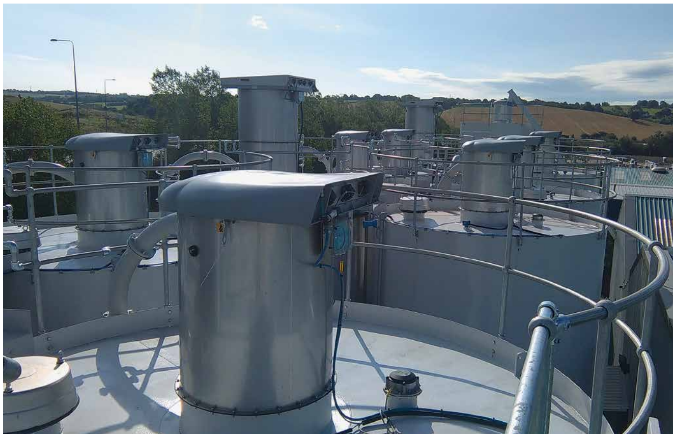
Silolanlage, die mit „Silotop“-Filtern und Silosicherheitsequipment ausgestattet ist
