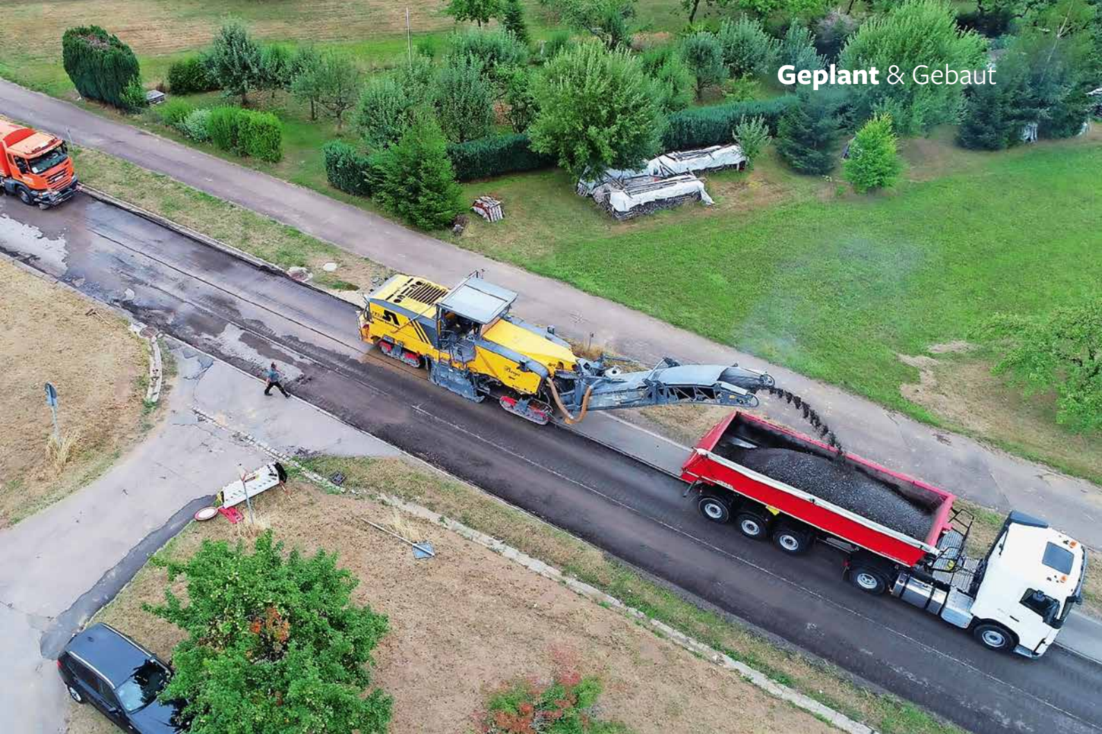
Einsatz von Profilfräsen bei der Sanierung der L 1151 zwischen Reichenbach und Schlichten in Baden-Württemberg
