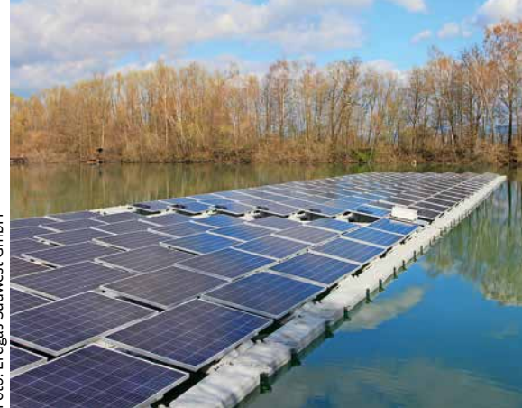
Die schwimmende PV-Anlage in Renchen.
