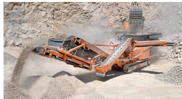
Einsatz des Rückführbandes als Haldenband, Erzeugung einer weiteren Endfraktion.
